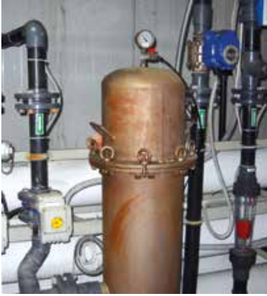
Resim 1. Paslanmaz Çelik Üzerinde Klorür Korozyonu
